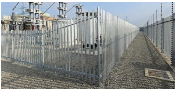
شکل ۲-۱۵- حصارکشی پست برق
