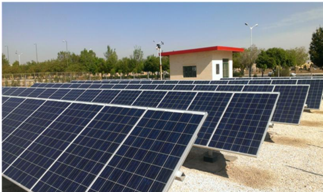
شکل ۵) نمای کلی نیروگاه دانشگاه یزد
